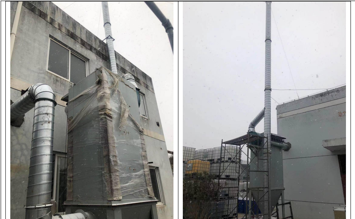
固体制剂包装车间二环保设施(10#排气筒) 固体制剂包装车间一环保设施(11#排气筒)
