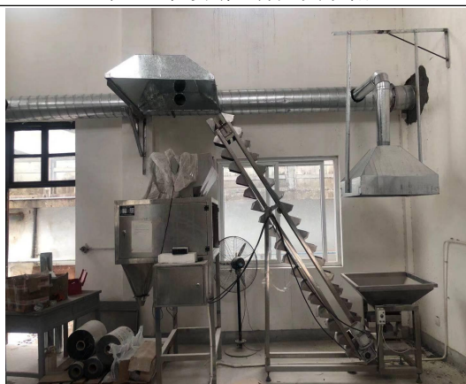
固体制剂包装车间二车间集气罩
