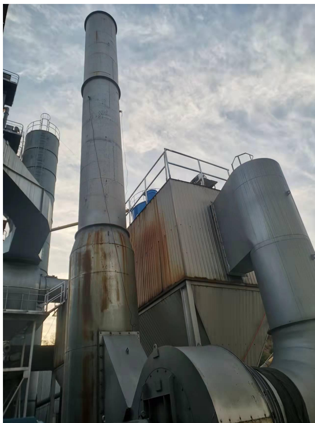
沥青混凝土生产线天然气燃烧废气、骨料滚筒加热粉尘、骨料筛分粉尘沥青罐呼吸废气、沥青混凝土出料过程产生的沥青烟气废气处理设施及排气筒 P2
