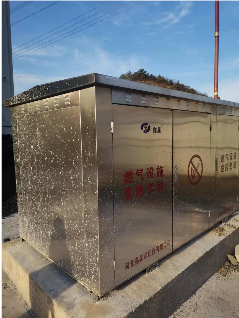
厂区内天然气调压站
