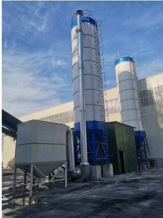
水泥稳定土生产线及搅拌仓粉尘废气处理设施及排气口 P5
