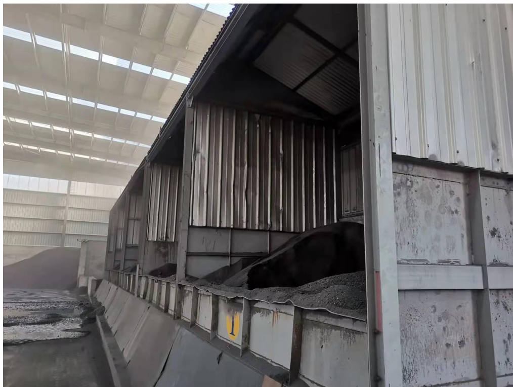
沥青混凝土生产线投料仓，投料仓顶顶部为抽风口
