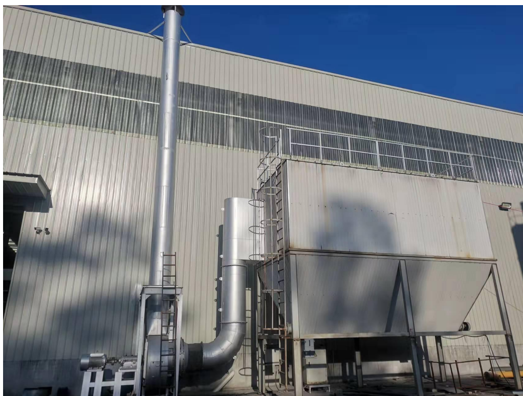
沥青混凝土生产线投料粉尘废气处理设施及排气筒 P1
