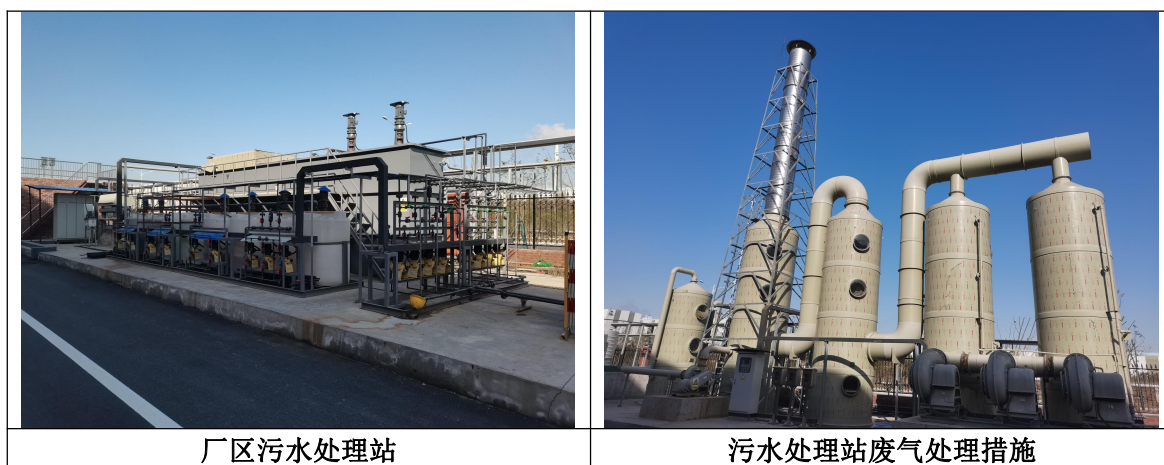
图4.1-2 废水处理措施照片
