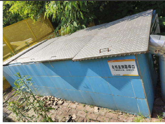
江淮汽车技术中心研发区污水处理设施
