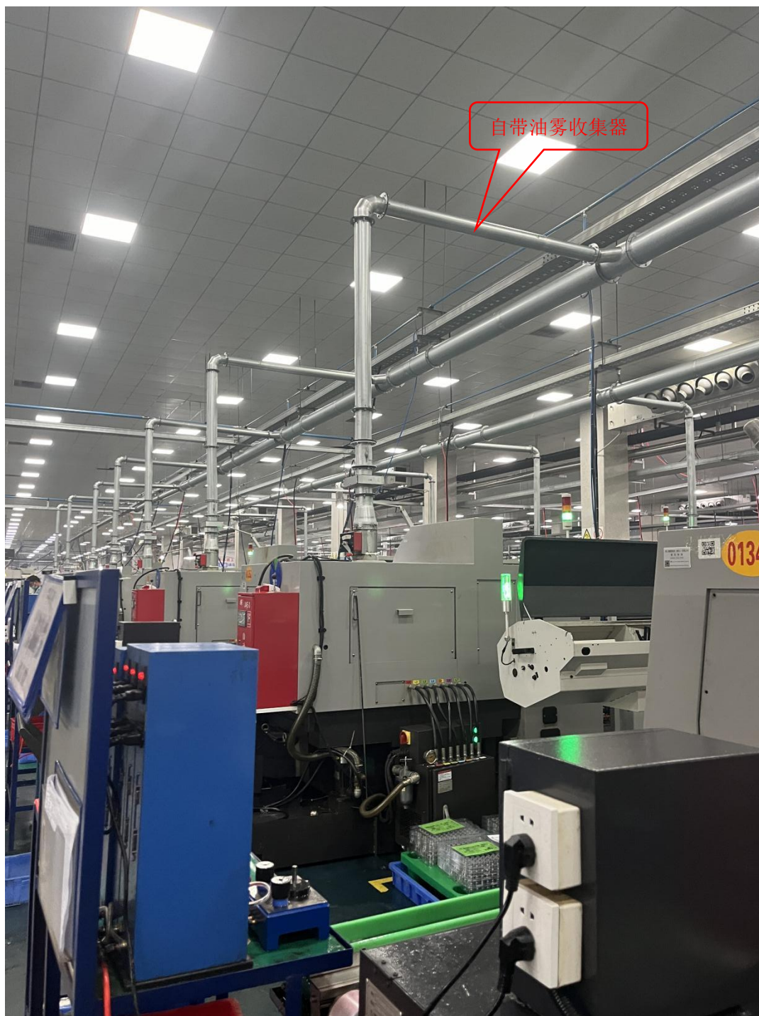
油雾收集管道
